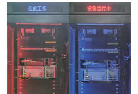
▲ 智能机柜屏头及机柜氛围灯
